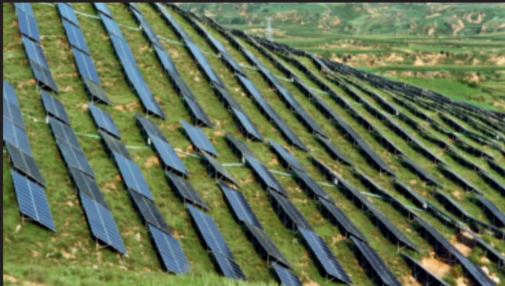
2015年8月10日,保定市涞源县全年日照时数长达2745个小时,光伏发电可有效利用的场地装机总容量约为2036兆瓦,已成为河北省沿太行山光伏规模化应用示范带重点县之一,图为河北涞源县境内已经并网发电的一个光伏发电项目。 新华社记者 王广壮摄
