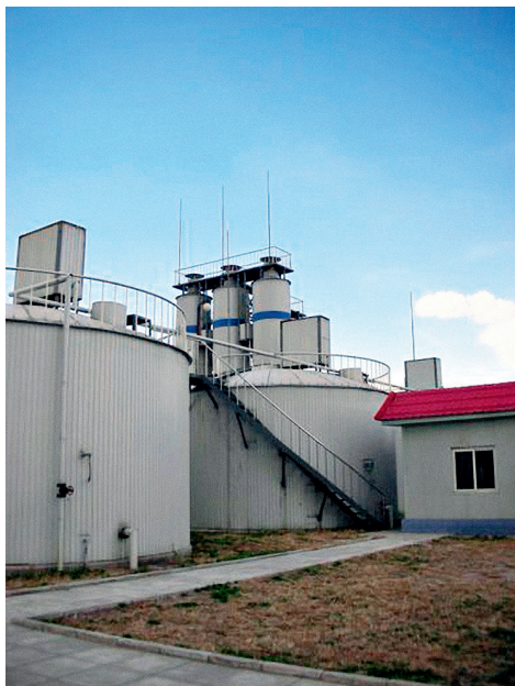
六里屯填埋场渗滤液处理设施 袁光钰/摄
